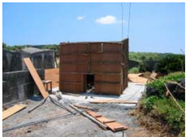
コンクリートの土台に 2 重の木枠を立て、そこに生コンを流し込む仕組み。その中には鉄筋を入れる。
